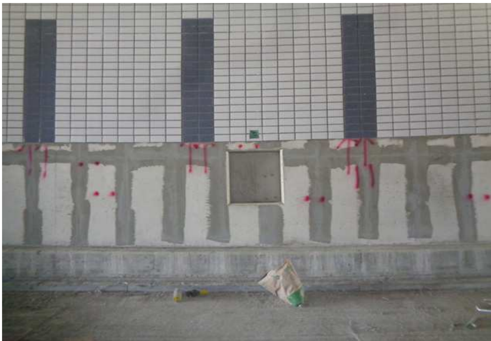
지하차도#1 소화기함 설치부 전경
